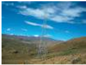
L.T. 220 KV CONOCOCCHA-HUALLANCA-CAJAMARCA NORTE - ABENGOA/HTN
