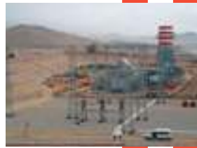
CENTRAL TERMICA LAS FLORES - DUKE ENERGY
